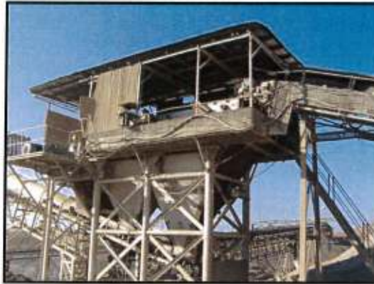
Φωτ.8.: Στέγαστρο στην περιοχή των κοσκίνων για την παρεμπόδιση της εκπομπής σκόνης
