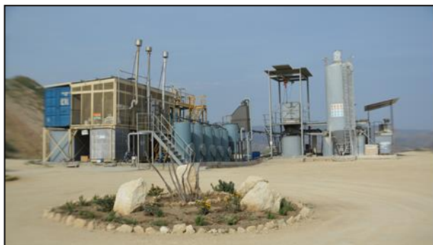
Εικ.6. Η εργοστασιακή μονάδα ADR
