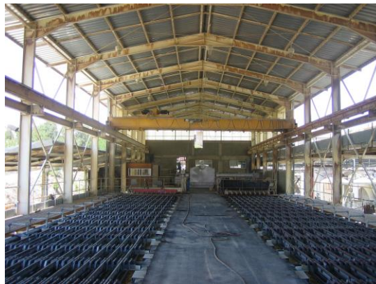
Εικ.5. Εργοστάσιο Ηλεκτρόλυσης
